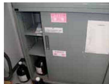
図5 施錠されていない保管庫
