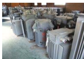
低濃度PCB変圧器
