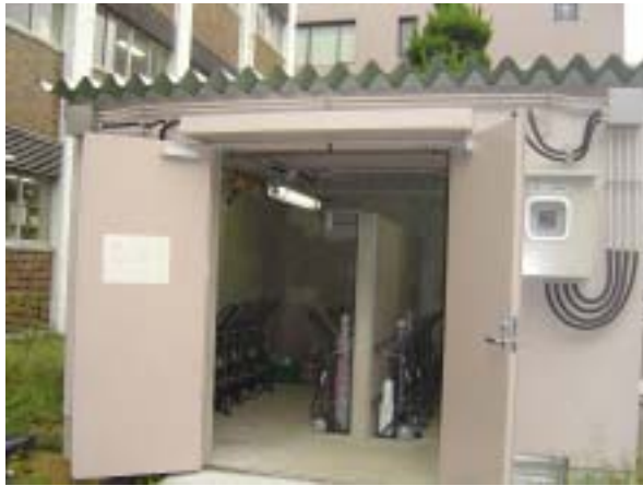
写真5. 屋外ボンベ庫
