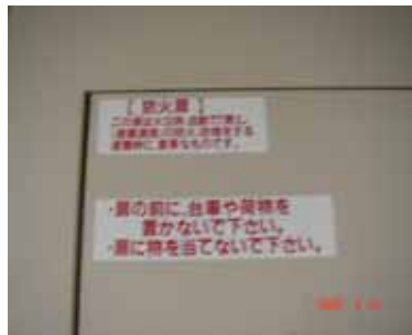
図2 防火扉の掲示（良い例）
