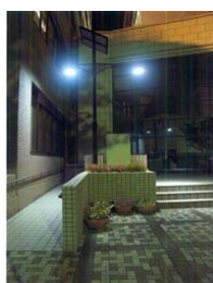
太陽電池と照明街灯
